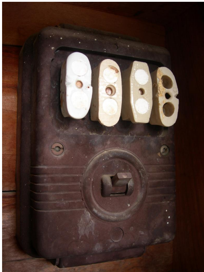
Quadro elétrico antigo
